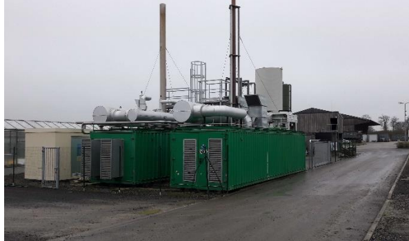
Valorisation du biogaz
