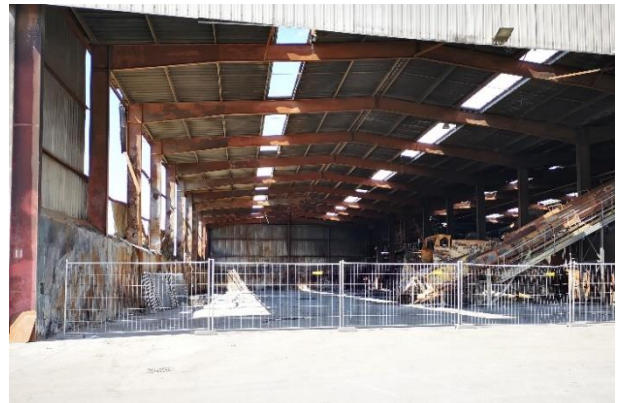
Photo 19 : Incendie du centre de tri de Rocquancourt (14)
